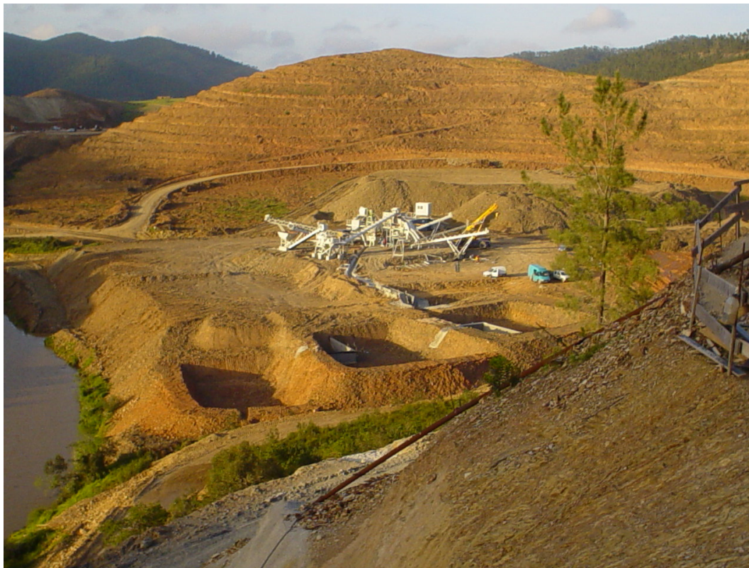
Área de processamento de materiais filtrantes e drenantes (Abril de 2003)
