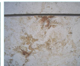
DEGRADAÇÃO DA PEDRA
