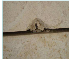
ROTURA NOS PONTOS DE INSERÇÃO DOS GATOS
